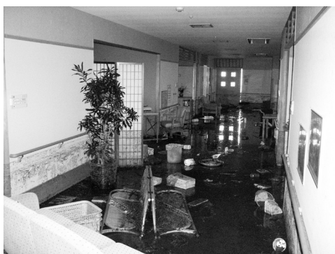
津波による浸水被害を受け、水が引いた後の施設内。パニック状態になっても不思議ではないなか「利用者全員の命を守る」との思いで全職員が避難対応にあたった。
